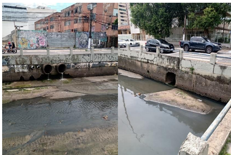
Figuras 22 e 23 – Estruturas de microdrenagem de áreas próximas ao canal da Tamandaré.
