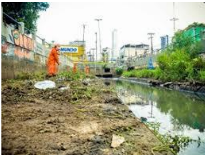
Figura 11 – Canal de drenagem com sólidos
