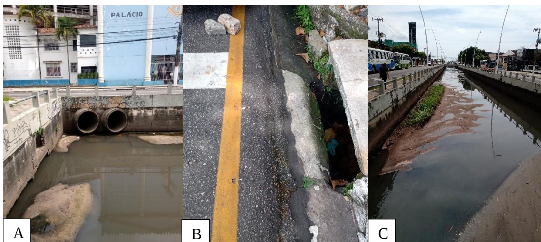
Figura 21 – Problemas identificados no canal da Tamandaré.
